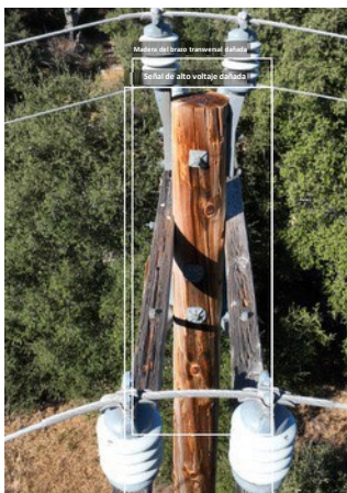
Detección de daño
